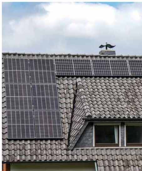
Gute Lösung: Photovoltaik
